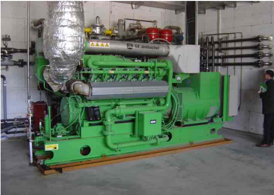
Abbildung 9: Blockheizkraftwerk mit Gas-Otto-Motor, Leistung 500 kW
