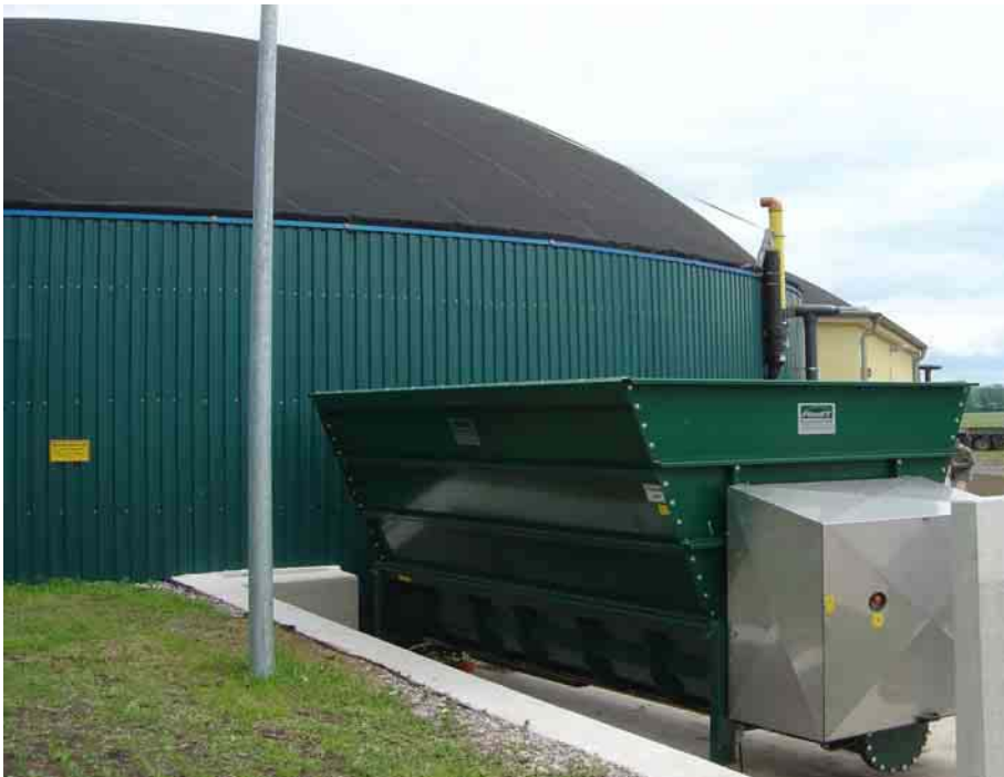
Abbildung 5: Feststoffdosierer (Presskolben) in einer Biogasanlage mit integriertem Gasspeicher
