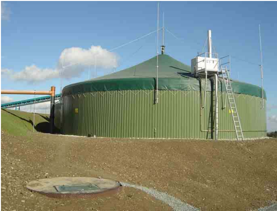
Abbildung 7: Biogasreaktoren mit Serviceschacht, Überdrucksicherung und Blitzschutzeinrichtung
