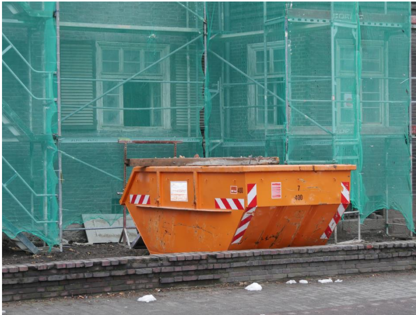
Abb. 2: Unmittelbare Lagerung von ggf. wassergefährdenden Abfällen auf einer Baustelle (Quelle [2])
